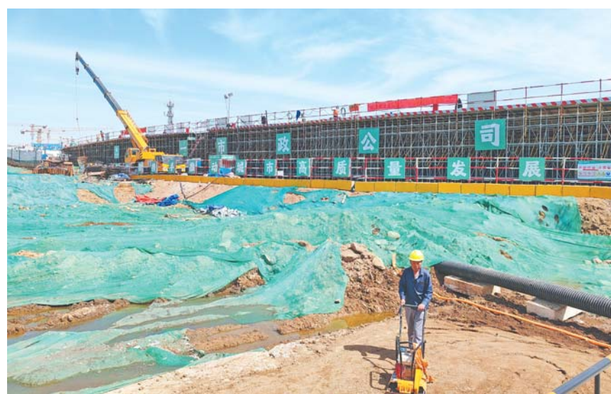
4月17日,在张村河一期综合治理工程现场,施工人员加紧施工桥体等设施。
