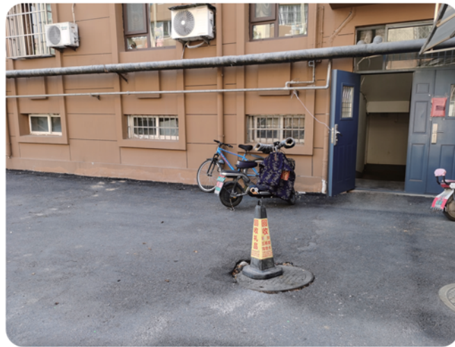
小区内6号楼前污水井盖塌陷。
