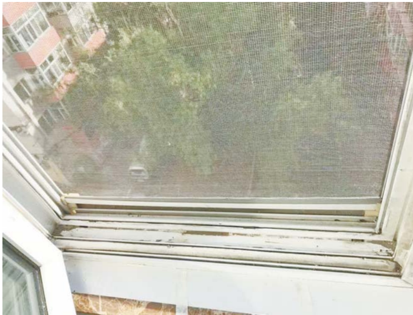
塑钢窗开关不畅，密封条已经脱落。
