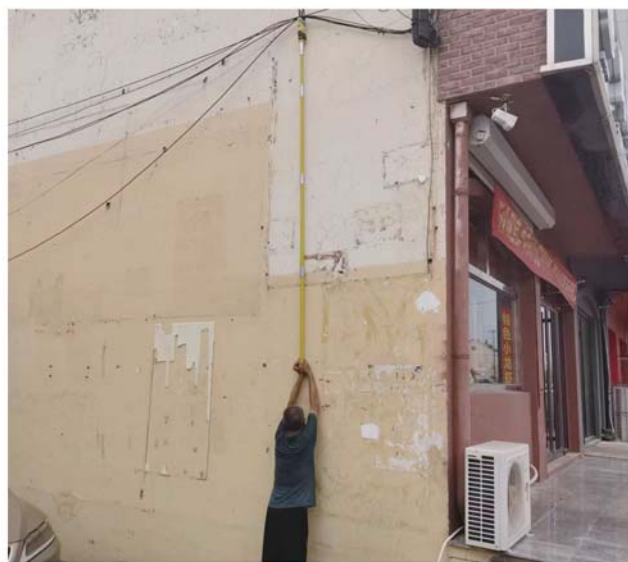
整治前的线缆比较杂乱。
