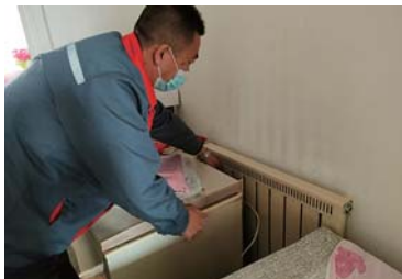
供热管家入户为用户检查暖气。
