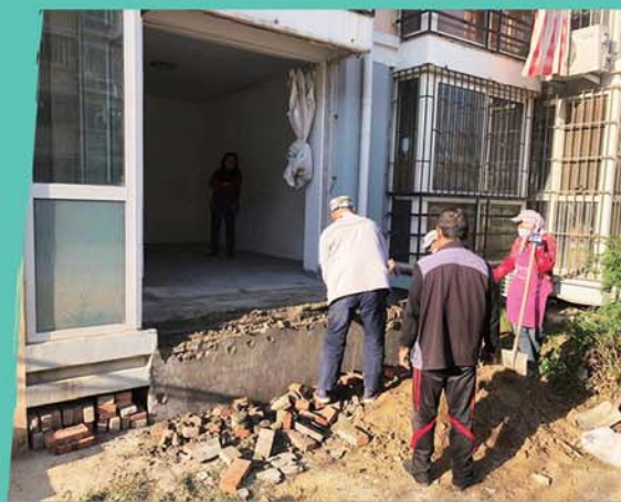
福林苑社区居民窗改门搭建平台,接到举报后当天安排人员进行了拆除。
