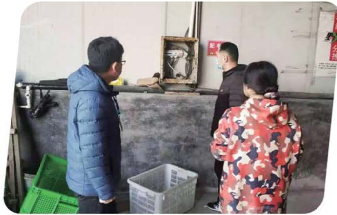
工作人员对配电设备进行检查。
