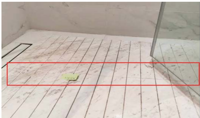
淋浴间石材断裂。
