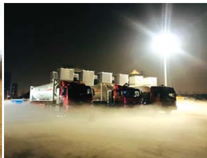
LNG卸车气化时出现雾气
