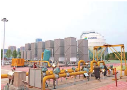
团结路门站LNG储备区
