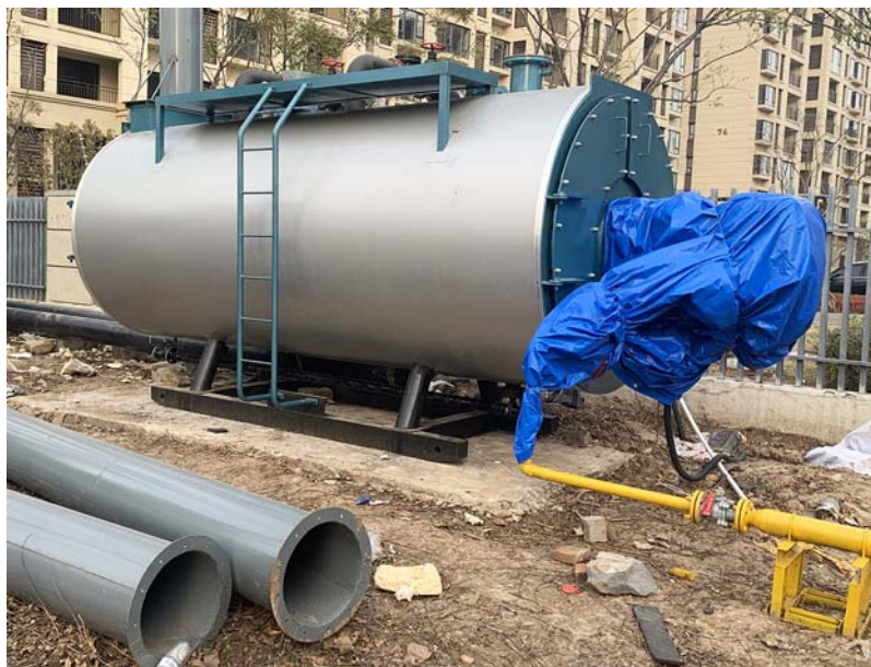
小区维修中的供暖设备。
