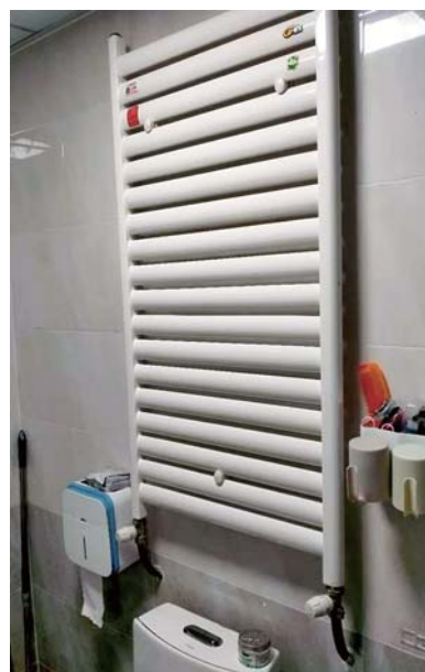
小区居民家中暖气片开始热乎。
