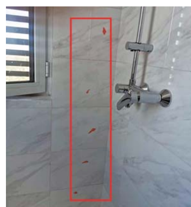
卫生间墙面空鼓。
