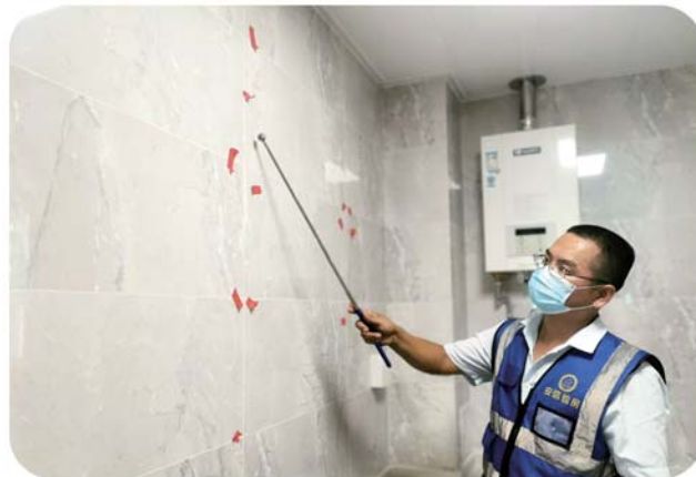
验房师正在查验墙面空鼓情况。
