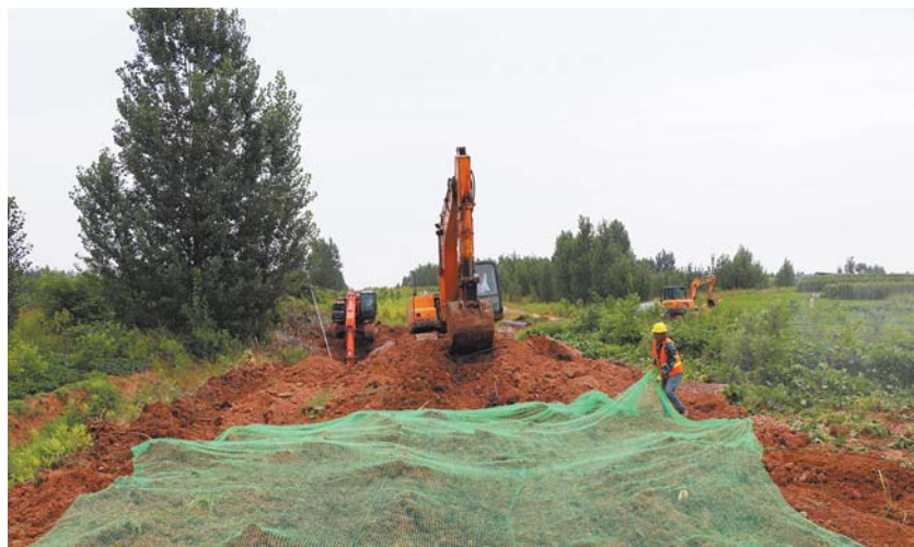
青岛胶州自来水有限公司加快胶西街道应急供水南线工程。
