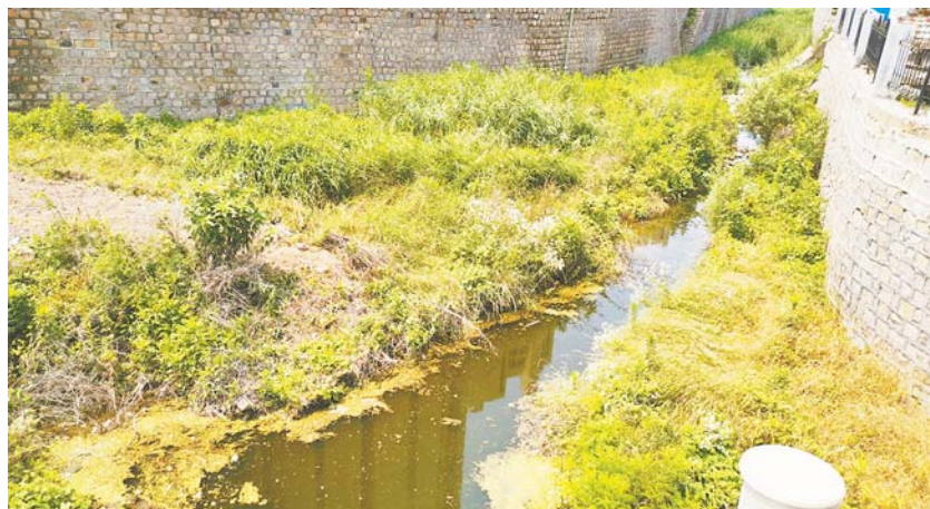
蒲河即墨区通济街道郭庄一村段无警示标志。
