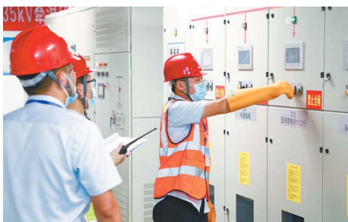
8号线北段顺利完成送电。
