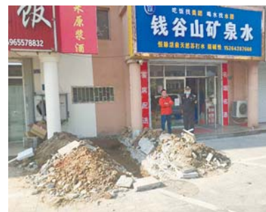
执法人员对违规擅自挖掘城市道路行为进行查处。
