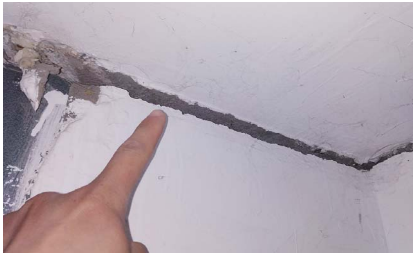
墙体出现的裂缝。
