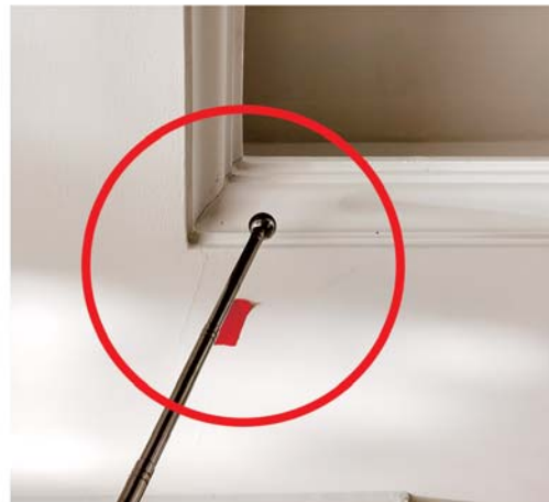
吊顶处有裂纹
