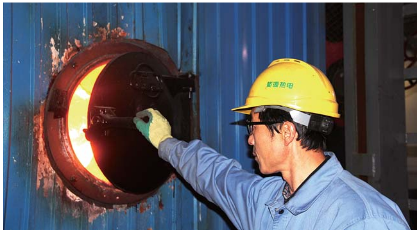
金泉热力工人正在检查锅炉。
