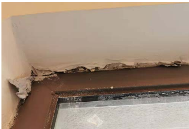
窗户框与墙体之间收缝不严。
