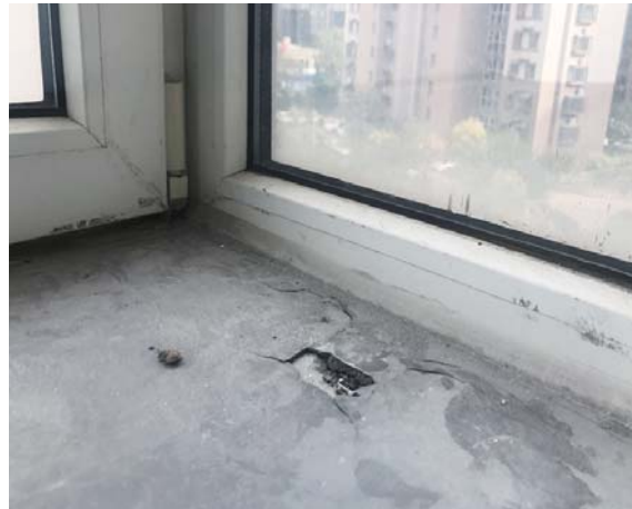
客厅东飘窗有积水现象并出现破损。
