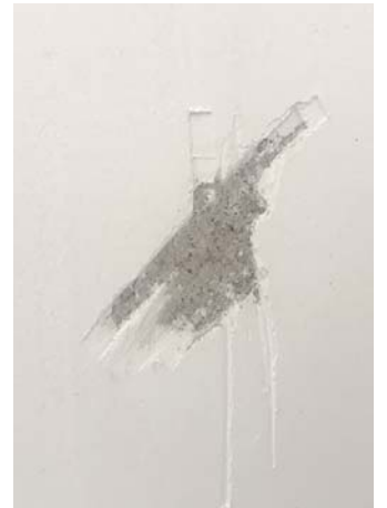
墙皮内是水泥,没有防裂网。
