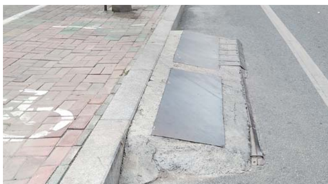
延伸到路上的违建斜坡。
