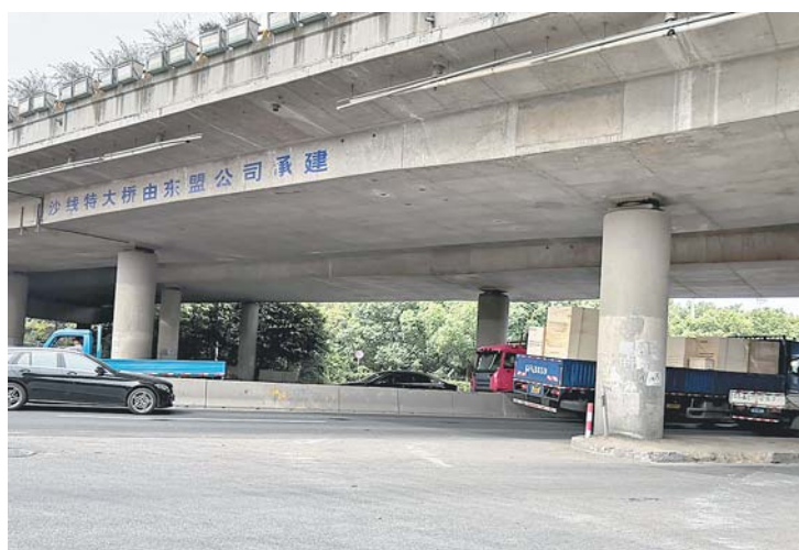
锡沙线特大桥部分路段桥面仅由一根柱墩支撑。
