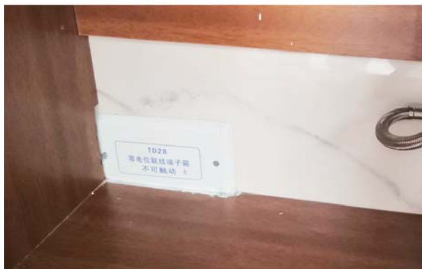
洗手间墙面等电位线与进水开关金属部件未连接。
