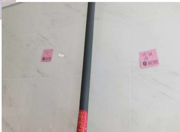
厨房墙砖有两处空鼓。
