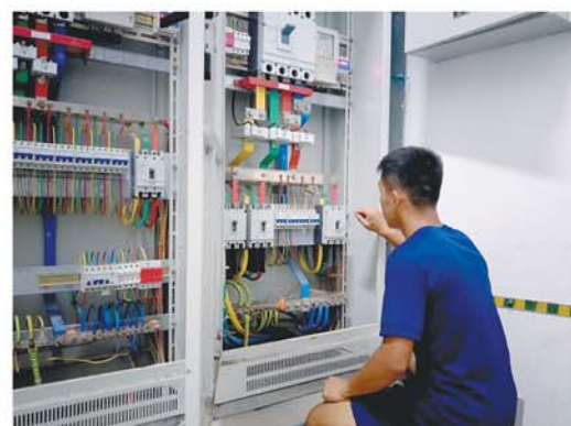
用电设备检查。
