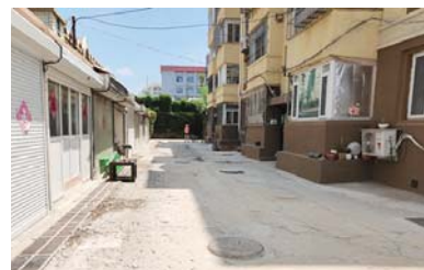
小区道路整治前坑洼不平。
