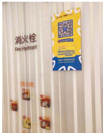
大融城消火栓上都用商场统一的贴纸进行了密封。
