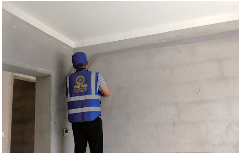
验房师正在检查墙面空鼓。
