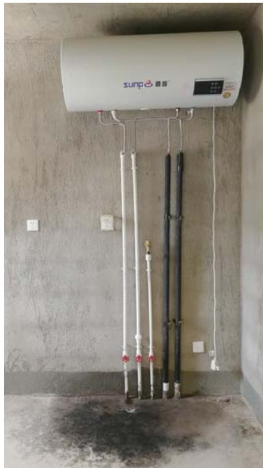
厨房热水器循环进口漏水。
