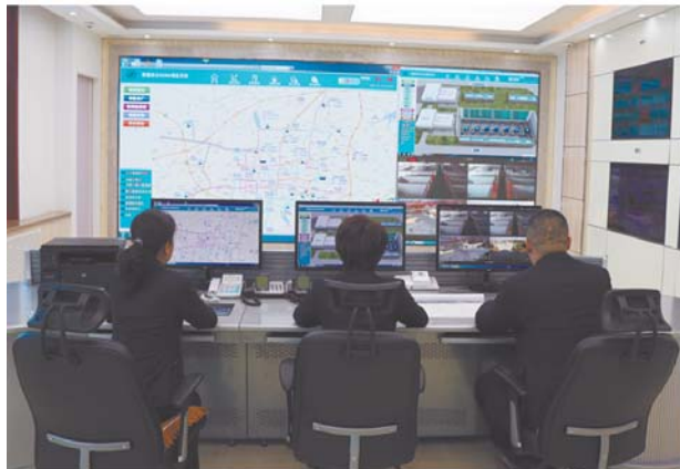
工作人员通过先进的调度系统密切关注全区的供水运行情况。
