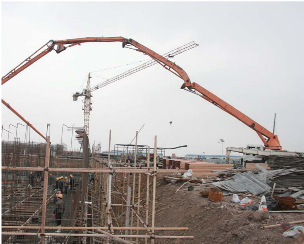
2015年新建黄家山水厂，利用莱西产芝水库的原水，为城区日增供水3万立方米。
