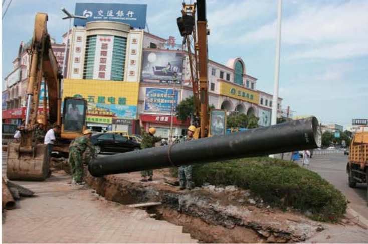
2009年7月，即墨自来水公司施工人员铺设城区鹤山路供水主管道。
