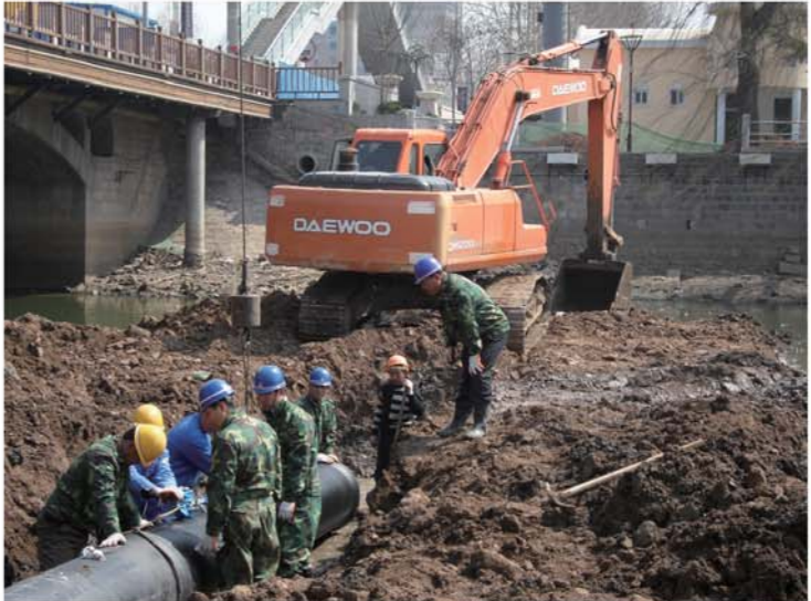
2009年蓝整路大修，即墨自来水公司施工人员安装穿越龙泉河的供水管道。
