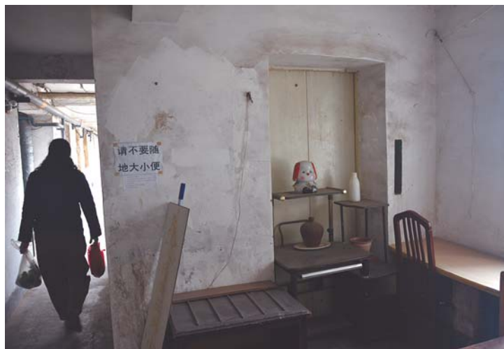
◀大沽路26号楼有电梯间，但已被杂物占据。
