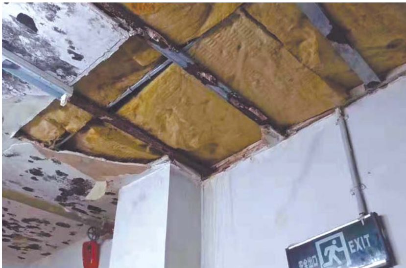
地下车库的顶部不少地方已经发霉，露出了建筑材料。
