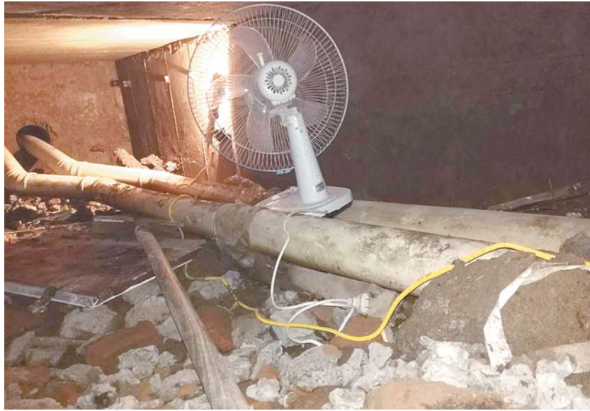
管道破裂污水横流。
