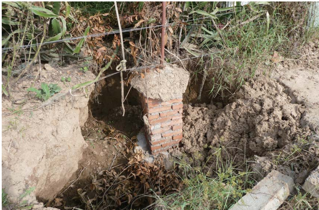
自来水管破裂后冲的大坑。
