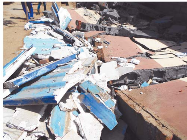
被拆除的违法建筑。
