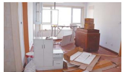
屋里堆满了装修垃圾。
